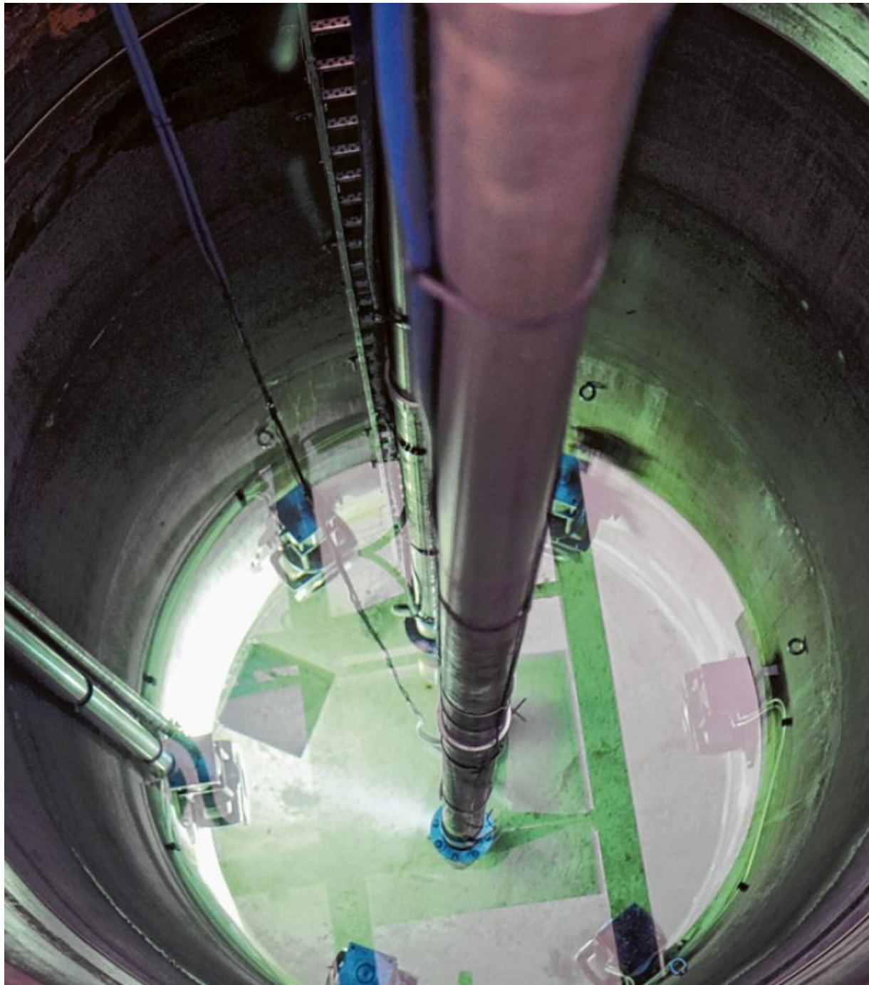
Tiefwasserbrunnen spielen bei der Versorgung der Bevölkerung, Unternehmen und Landwirte eine immer wichtigere Rolle. Bei Hitzewellen wie der aktuellen steigt der Bedarf spürbar an.
