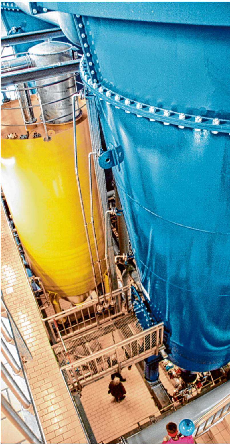
Die Rieswasserversorgung hat in Berghausen eine große Trinkwasserenthärtungsanlage gebaut, um das Wasser für die Verbraucher zu verbessern. Archivfoto: von Neubeck
